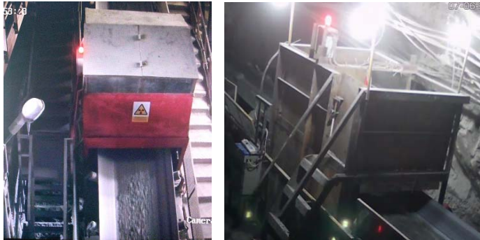
А. КОФ. Конвейер № 4 Б. ННР. Магистральный конвейер
